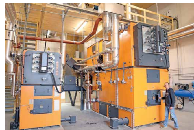
Lukas Frei examine l'installation – il est membre du conseil d'administration de la coopérative de chauffage Knonau.
