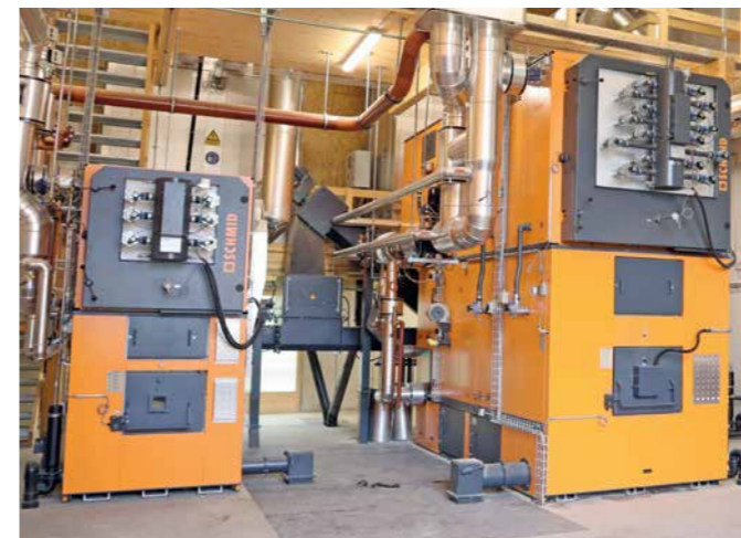
Chaudière à grille d'alimentation Schmid Chaudière 1: UTSR-1600.32-1 visio / Chaudière 2: UTSR-550.32-1 visio
